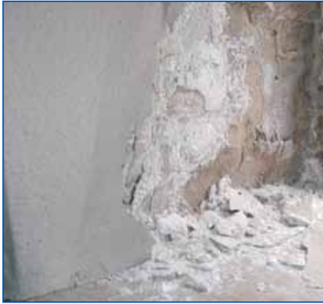
1 Zidărie umedă, saturată și cu încărcătură de sare.
